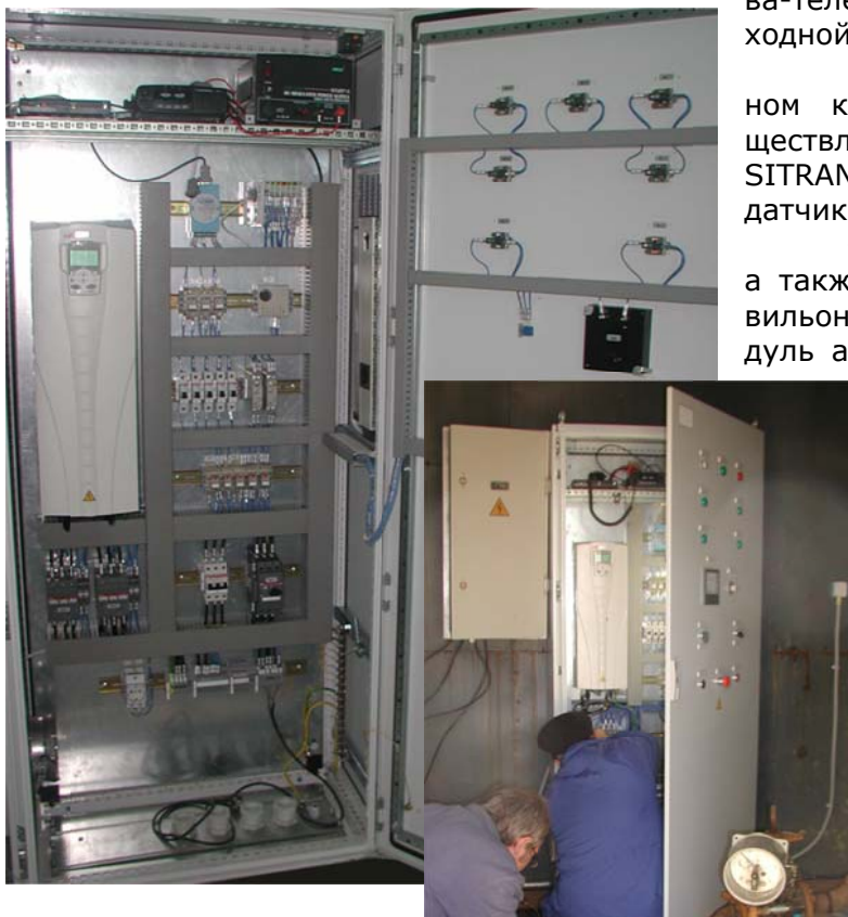
Рис. 1. Шкаф управления насосной станцией.
