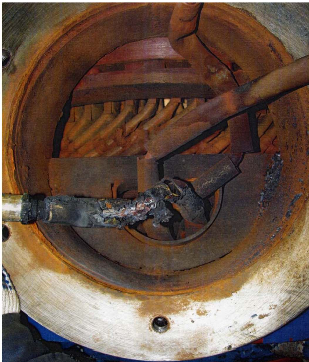
Рис. 8. Термическое повреждение изоляции силового кабеля и выводов обмоток электродвигателя в коробке выводов
